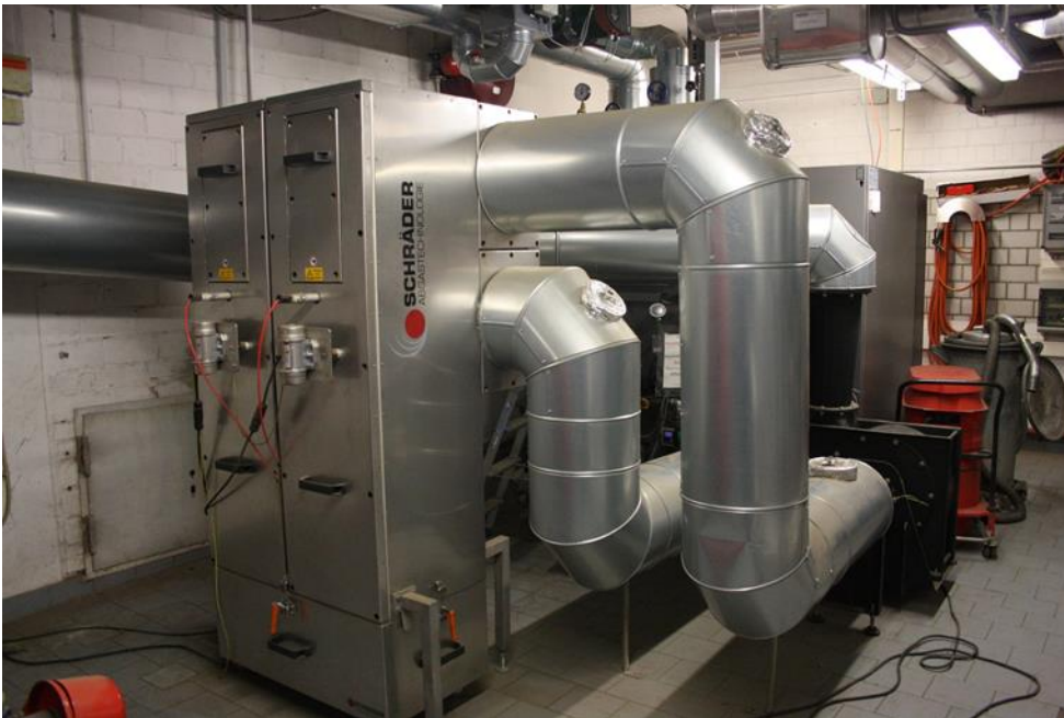
Abbildung 2: Hackschnitzelkessel mit Hochvoltabscheider für Feinstaub 1
