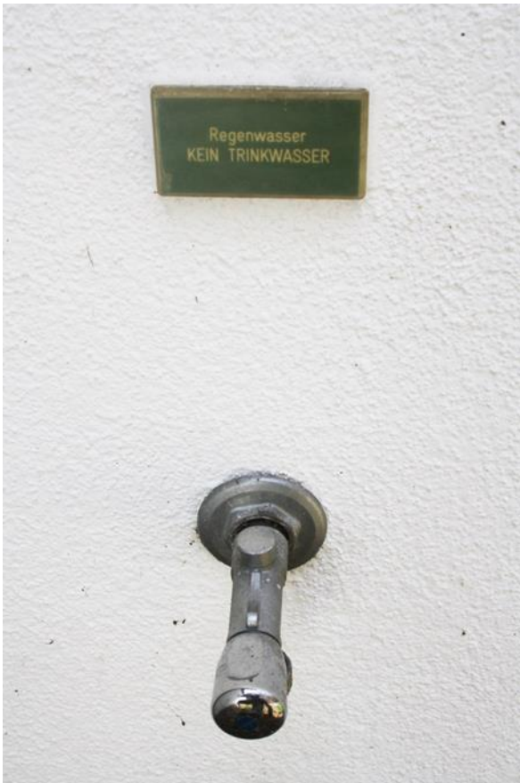
Abbildung 7: Brauchwasserhahn zur Gartenbewässerung
